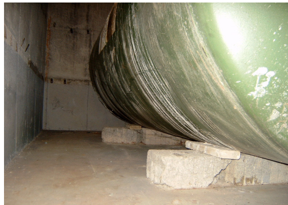
Illustration: Citerne à mazout à simple coque datant des années 1970 dans un local spécialement étanchéifié pouvant contenir d'éventuelles fuites.
